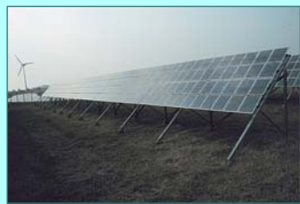
Photovoltaikanlage Mit Solarzellen wird elektrische Energie aus dem Sonnenlicht gewonnen. Die erzeugte Gleichspannung wird mit Hilfe von Wechselrichtern in das Netz eingespeist. Gleichzeitig sorgen sie dafür, dass die maximal mögliche Leistung eingestellt wird.
